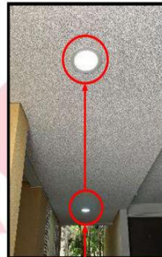
PANELES LED CON SENSOR EN LOS PASILLOS DE INGRESO A LOS APARTAMENTOS DEL PRIMER PISO DE LA TORRE A Y TORRE B
