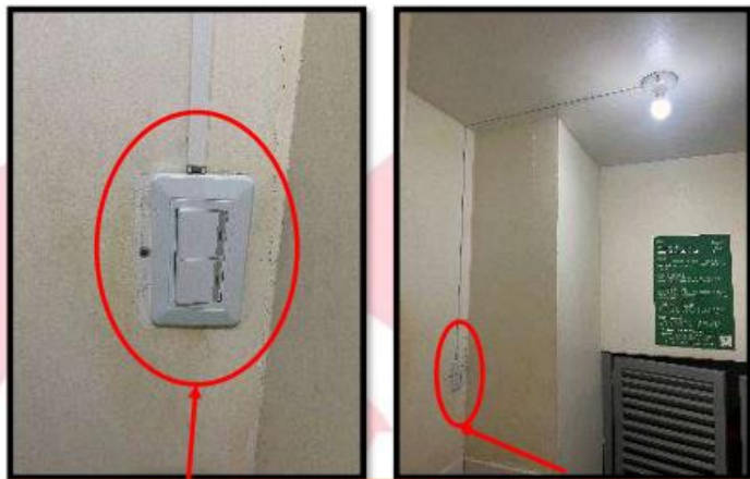
INTERRUPTOR DOBLE DE INCRUSTAR PARA CONTROLAR EL ENCENDIDO Y APAGADO, UBICADO EN EL CUARTO DEL SHUT DEL PRIMER PISO, TORRE B
