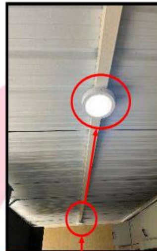
DOS PANELES LED CON SENSOR EN EL ÁREA DE INGRESO AL PASILLO PRIMER PISO TORRE B
